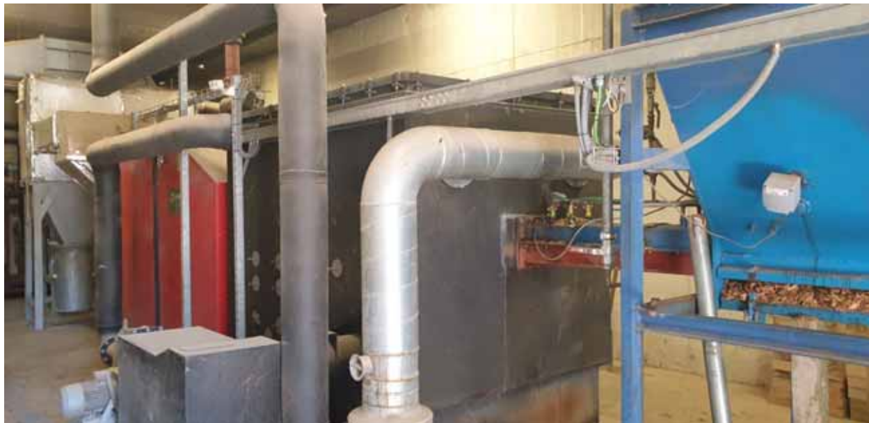
Chaudières avec la trémie d'alimentation
