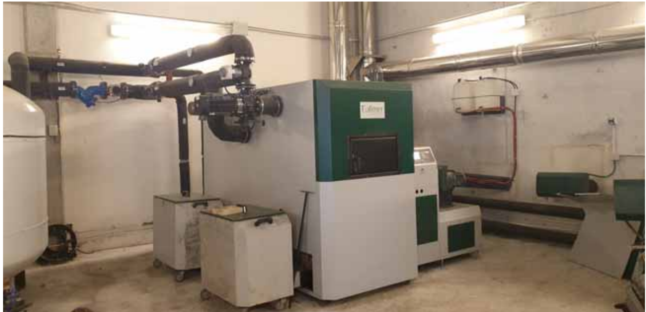
Sala de calderas
